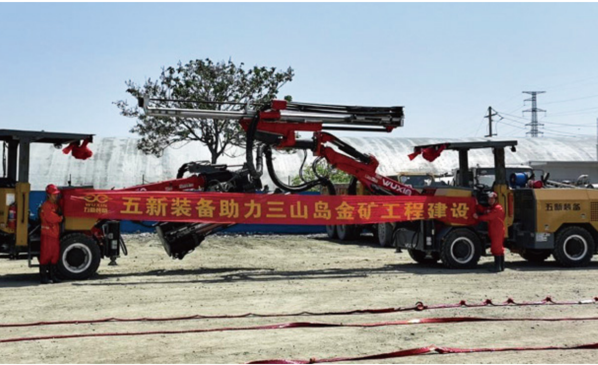
山东黄金三山岛金矿(高温、高湿、高腐蚀) 断面: 4.0m×4.0m / 4.0m×4.5m
